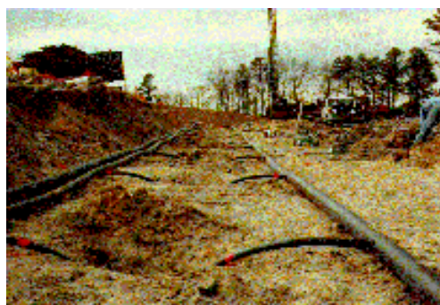
Figura B.36 vista dos tubos laterais GEO-00
